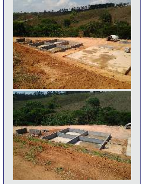
ETE III (Córrego Caxambu / Novo Horizonte)
